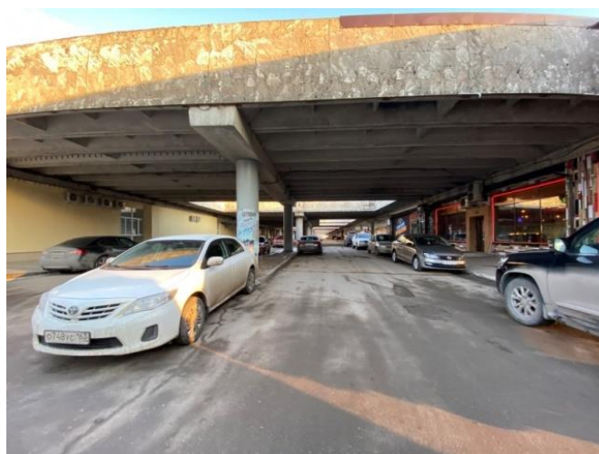
Рисунок А.17 – Состояние моста между ТЦ «Русь на Волге» и АВТОГРАДОМ
