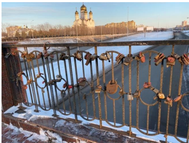
Рисунок А.18 – Состояние ограждения пешеходного моста над Ленинским проспектом
