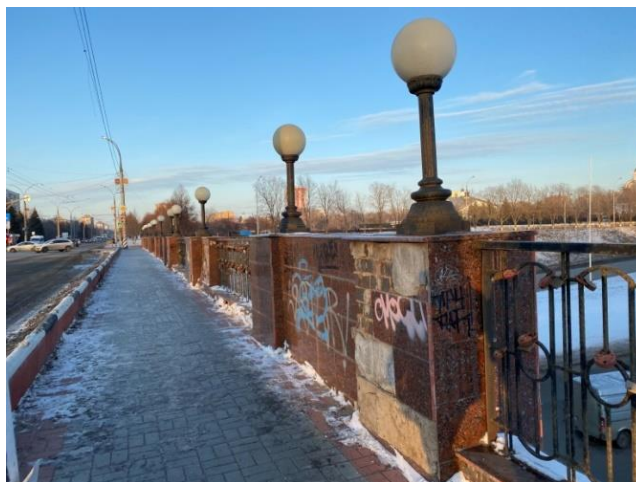
Рисунок А.19 – Состояние пешеходного моста над Ленинским проспектом
