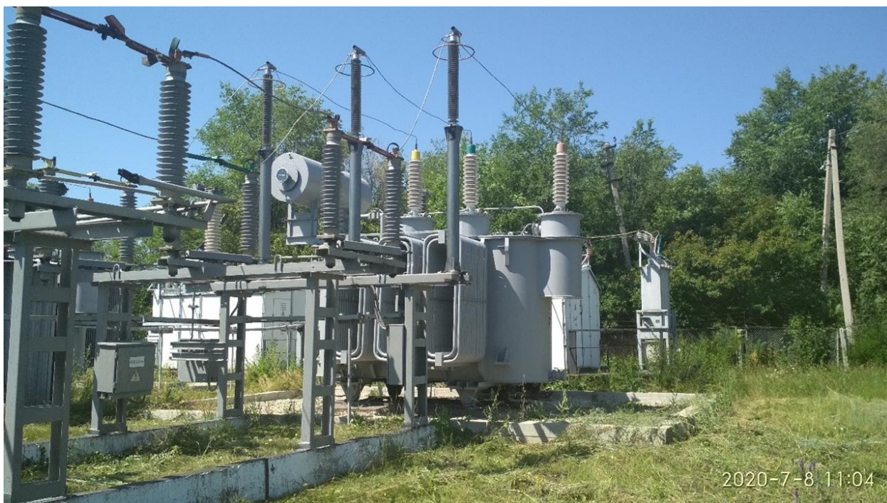
Рисунок 9 – ТМН-6300, установленный на ПС «Парфеновка»
