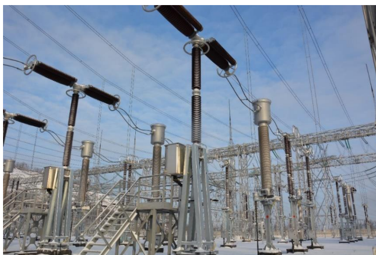
Рисунок 1 – Фото оборудования ОРУ-500 кВ
