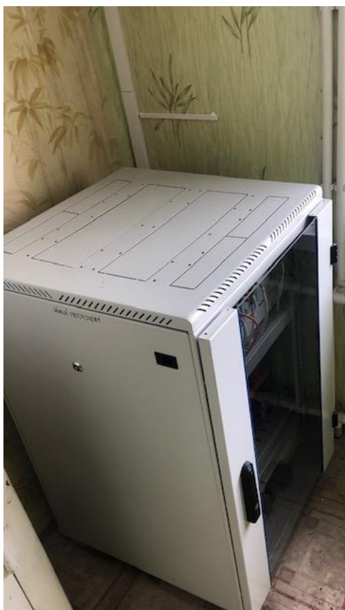
Рисунок 10 – Установленный комплекс П-166 ИТК ОС КГО
