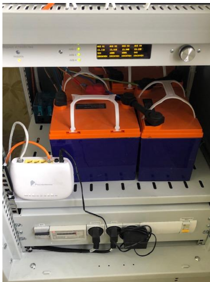
Рисунок 11 – Расположение оборудования в комплексе П-166 ИТК ОС КГО
