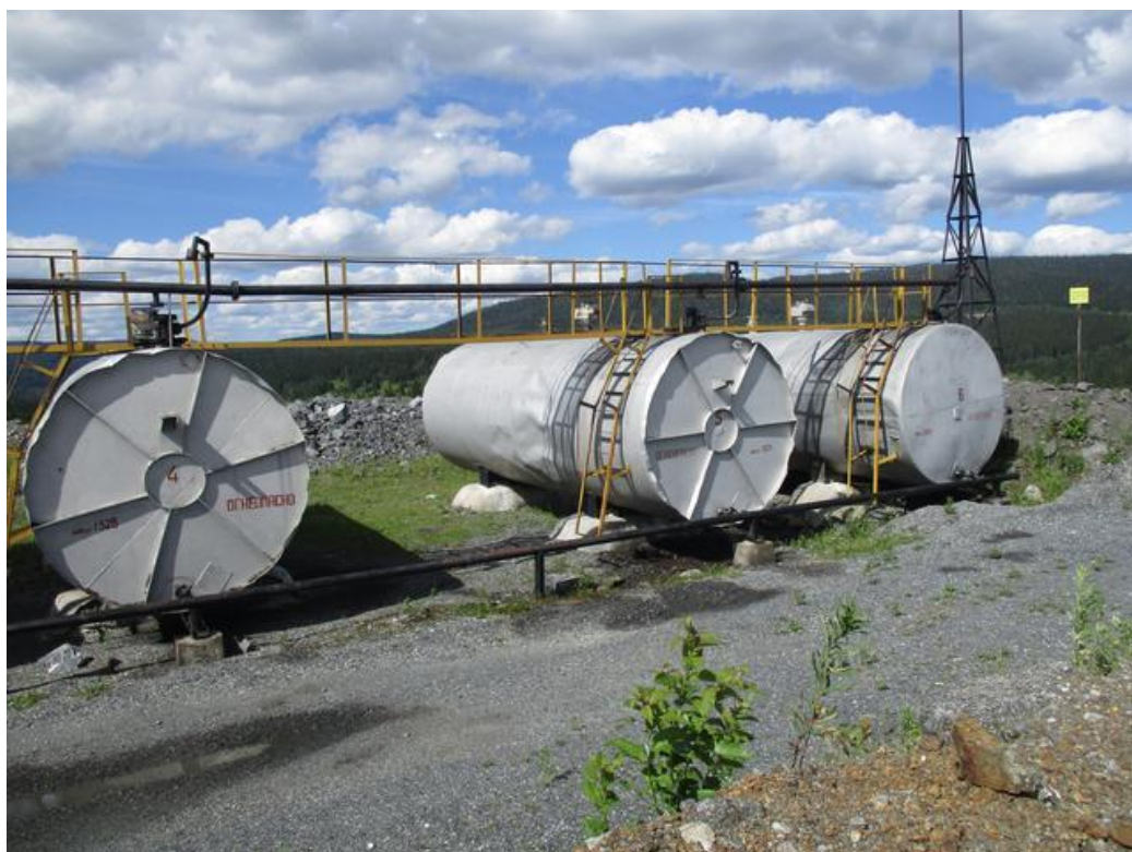
Рисунок 3 – Фотография территории нефтебазы КШНР: резервуар хранения дизельного топлива (наземный).
