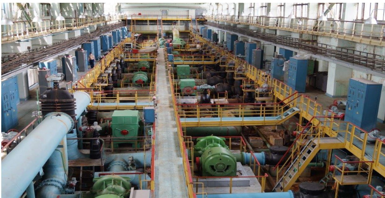
Рисунок 4 – Насосная станция второго подъема [3]
