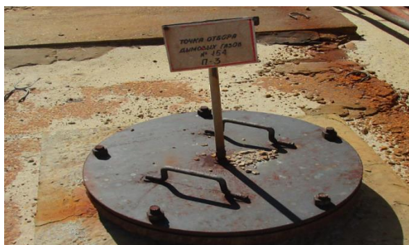
Рисунок 2.14 – Установка Л - 24/7. Точка отбора (люк) проб источника №0154, печь 3
