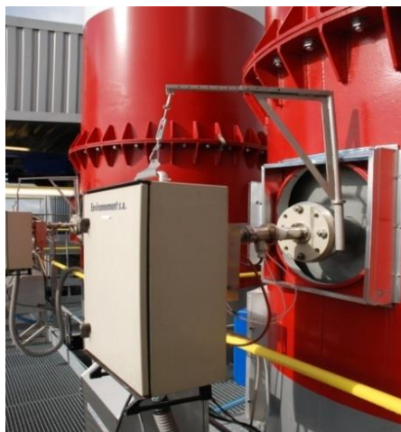
Рисунок 2.19 – Вариант монтажа системы отбора пробы SEC на дымовой трубе [43]
