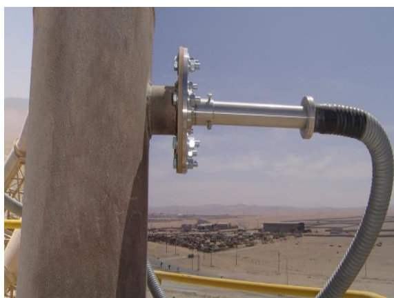
Рисунок 2.20 – Вариант монтажа пробоотборного зонда в газодымовую трубу [43]
