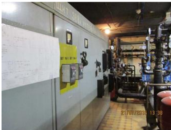
Рисунок 4 – Существующее РУ-0,4кВ КСК ЖГЭС
