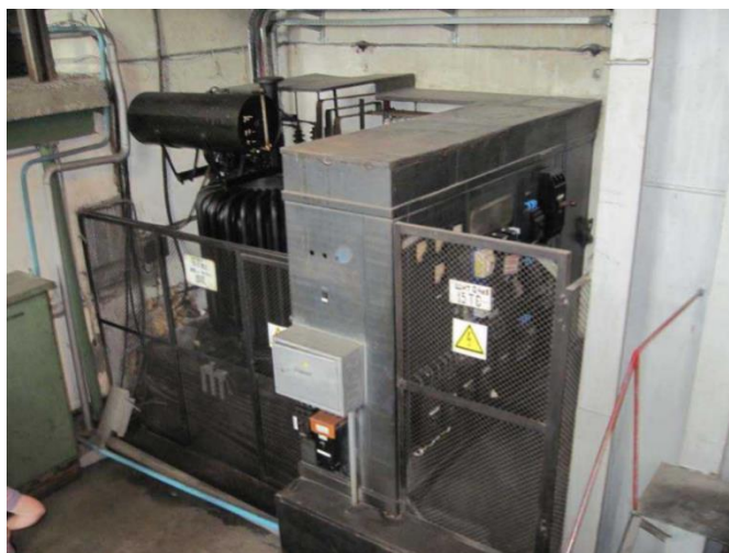
Рисунок 3 – Внешний вид щита 0,4кВ 15ТС ЖГЭС
