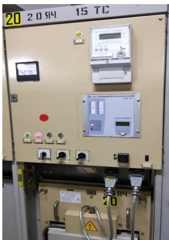
Рисунок 2 – Внешний вид вводной ячейки трансформатора 15ТС ЖГЭС
