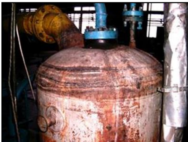
Рисунок 1.7 – Несоответствующие требованиям сварные швы после ремонта
