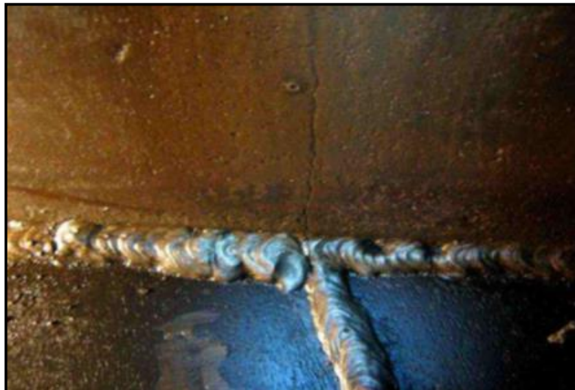
Рисунок 1.3 – Трещина в сварном шве (вид с внутренней стороны) [7]
