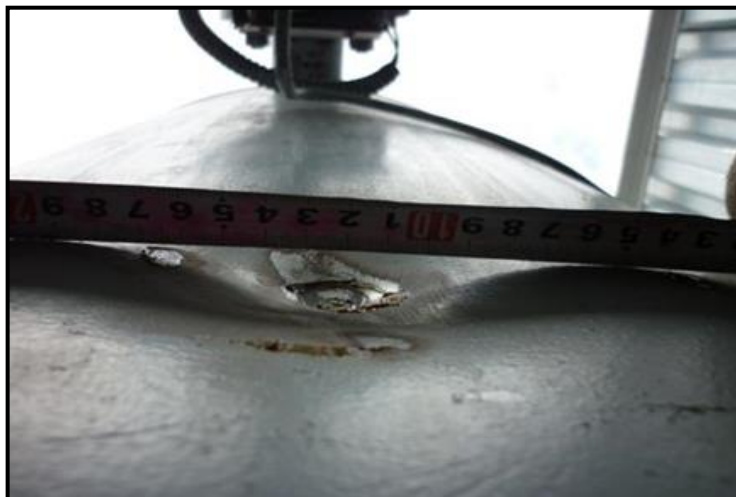
Рисунок 1.4 – Вмятина на корпусе теплообменника
