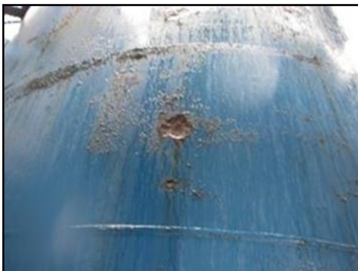
Рисунок 1.6 – Язвенная коррозия корпуса воздухоборника
