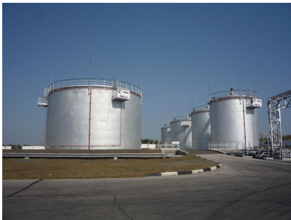
Рисунок 9- Резервуарный парк ЛВЖ ГЖ
