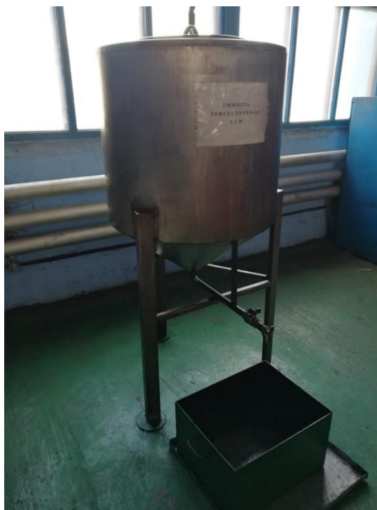
Рисунок 4 – Резервуар для приготовления смазочно-охлаждающей жидкости
