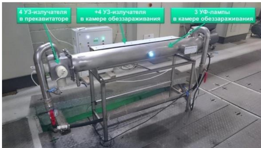
Рисунок 12 – Установка УОВ-СВ-5, разработанная ООО «Новотех-ЭКО»
