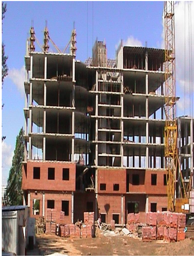
Рисунок 2.1 – Общий вид жилого дома
