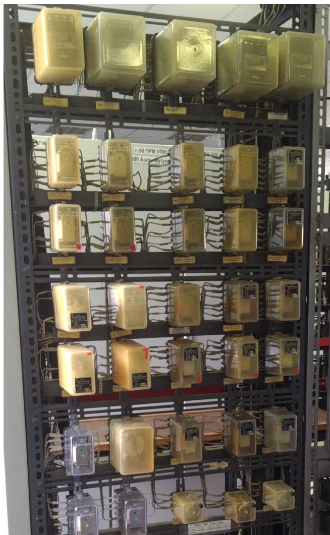
Рисунок 3 – Внешний вид панели УРЗиА, выполненной на электромеханических реле
