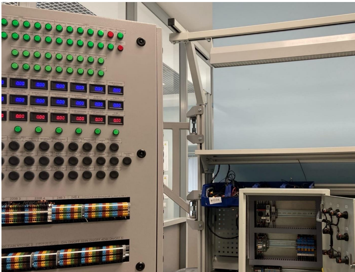
Рисунок 42 – Стенд с подключенным на проверку ШУ
