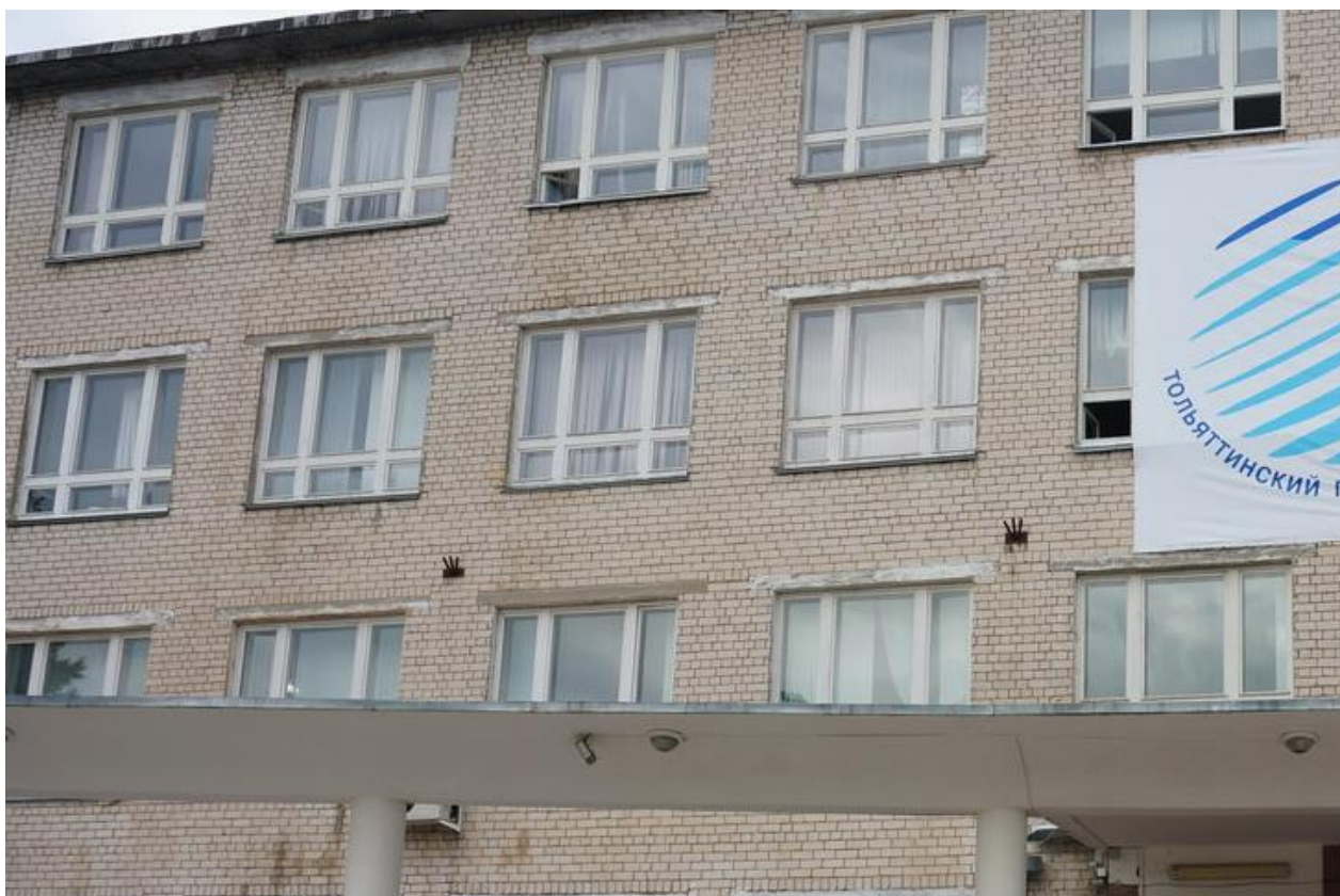
Рисунок 2 –Старые деревянные рамы на фасаде ТГУ
