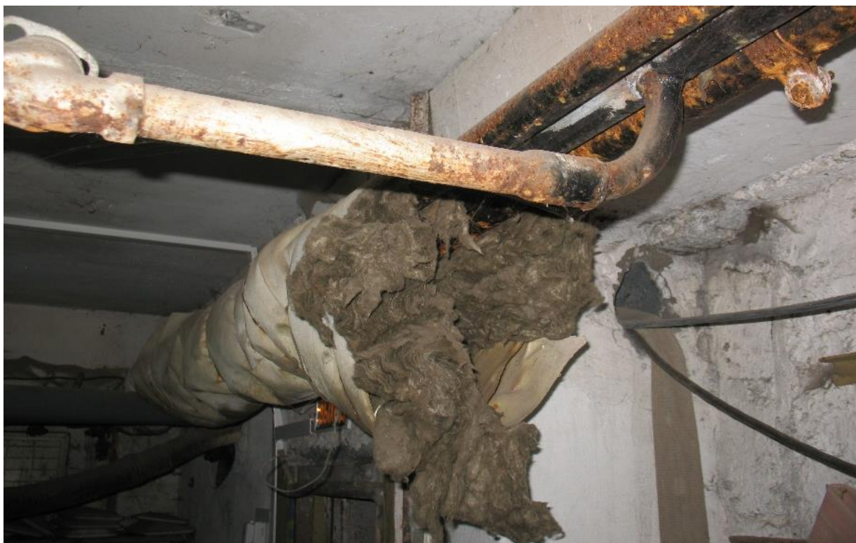
Рисунок 16 - Рисунок 17 – Частичное отсутствие тепловой изоляции
