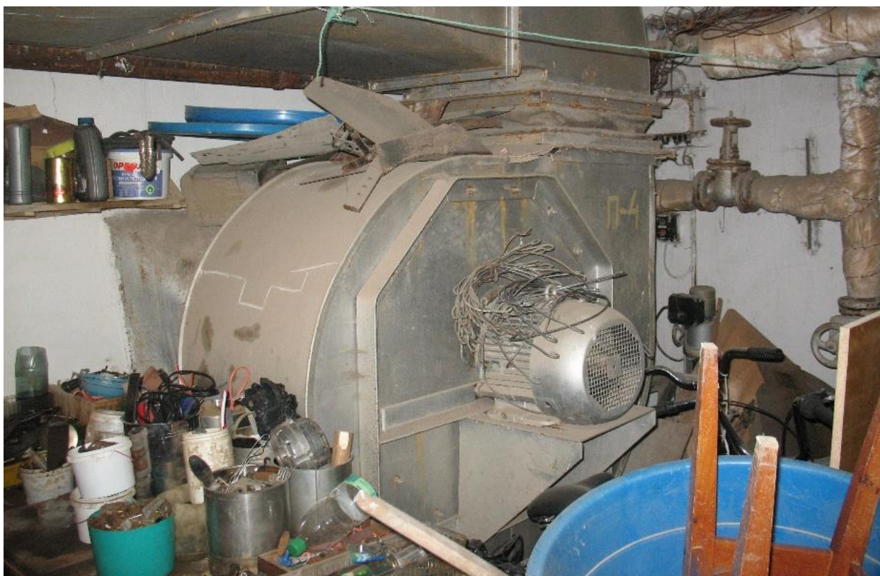
Рисунок 10 - Вентилятор приточной системы П-1.
