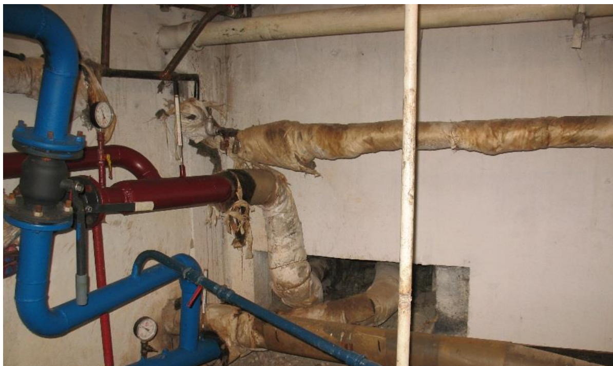
Рисунок 15 – Ввод тепловой сети в корпус
