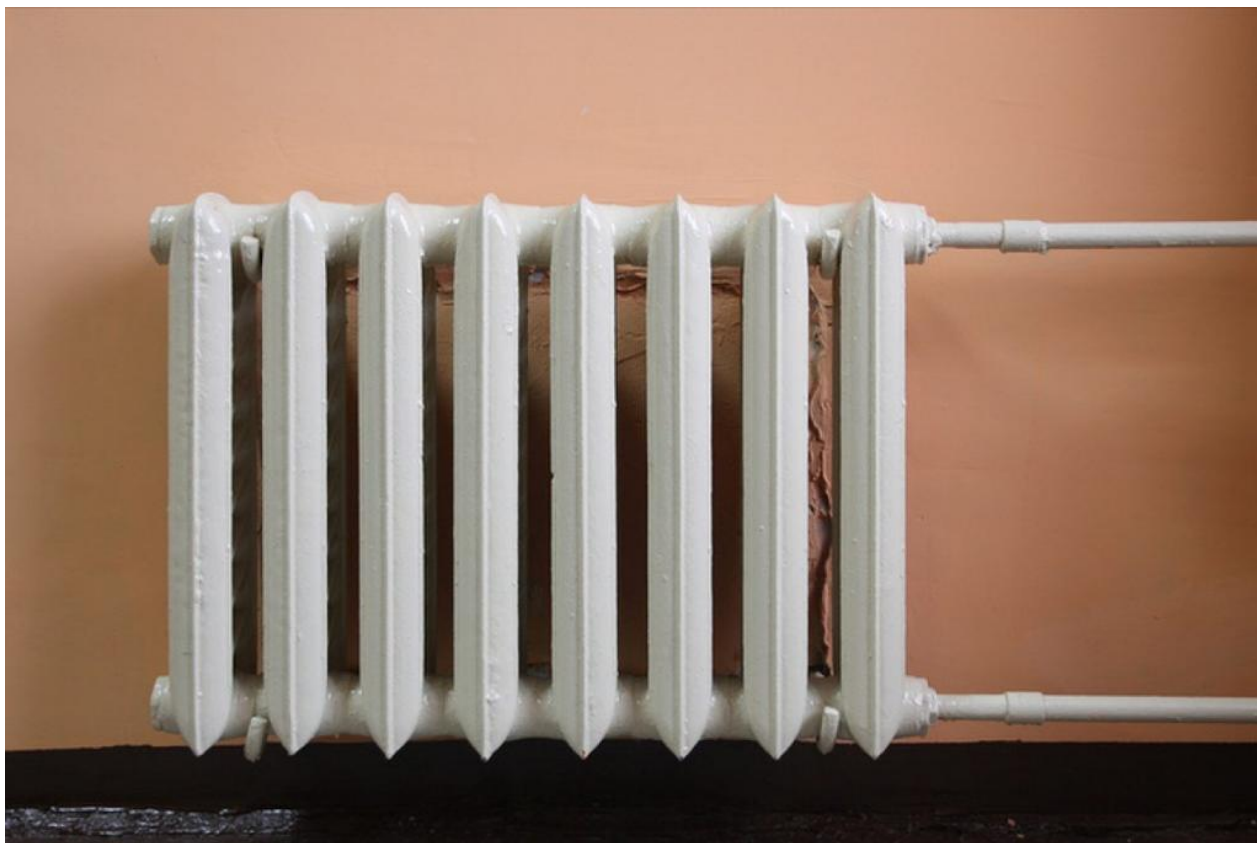
Рисунок 12 – Радиатор отопления в помещении корпуса
