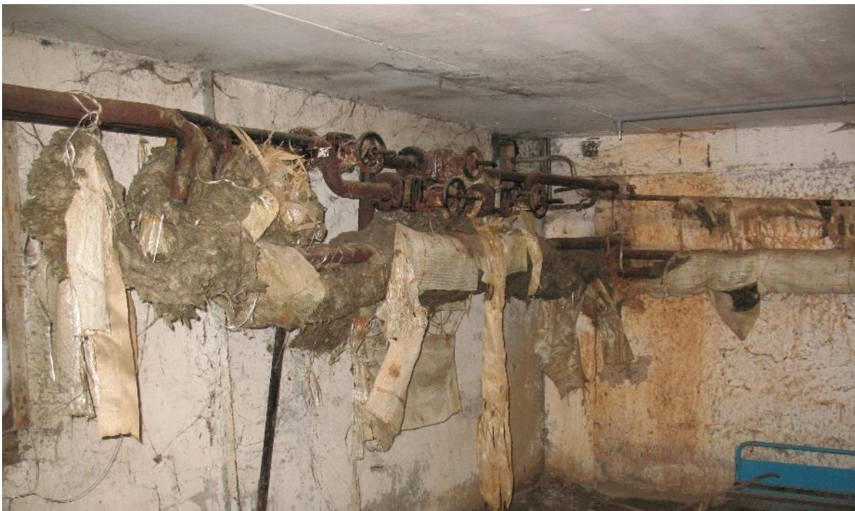
Рисунок 19 – Свисающие лохмотья тепловой изоляции
