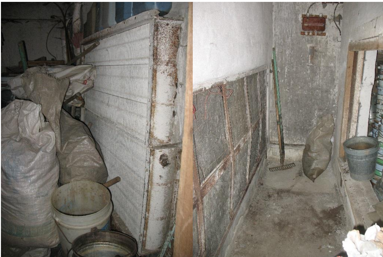
Рисунок 11 – Венткамера приточной системы №3
