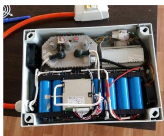
Рисунок 27 - Контроллер и аккумулятор беспилотного электрокара
