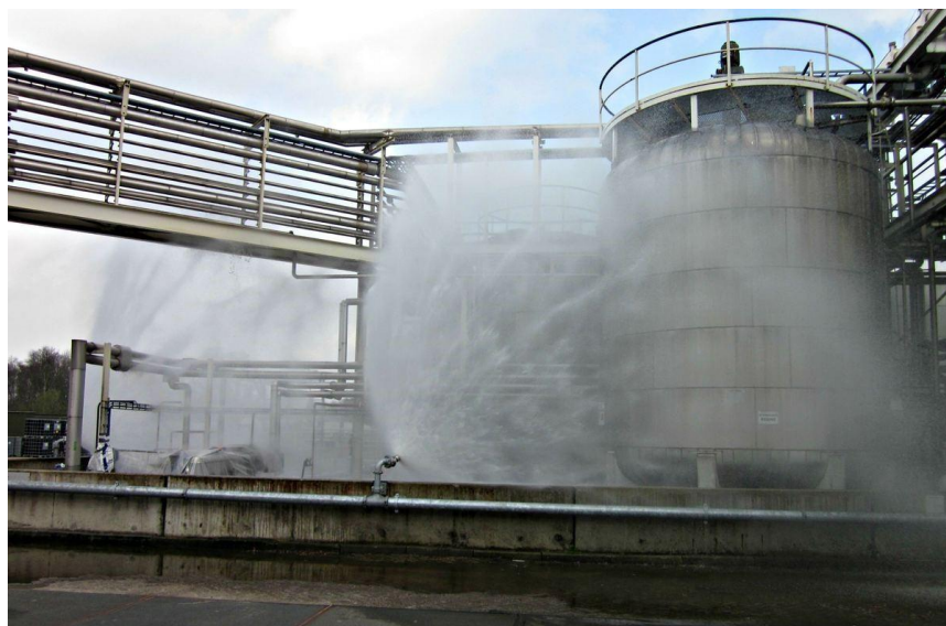
Рисунок 7 - Работа системы орошения технологических установок для охлаждения их конструкций и трубопроводов
