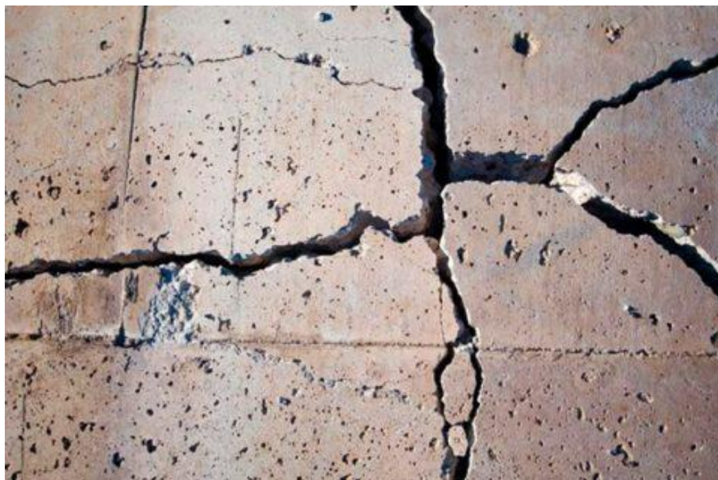
Рисунок 1.3 – Бетон с образовавшимися трещинами
