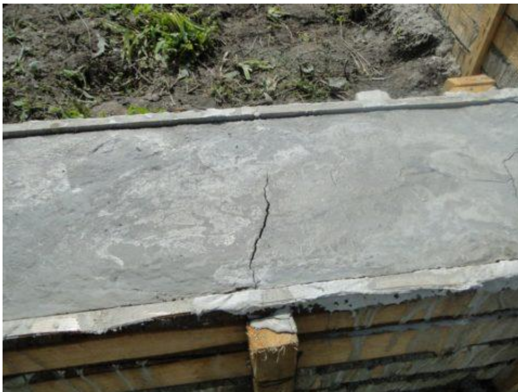
Рисунок 1.4 – Трещина в бетоне, вызванная усадкой
