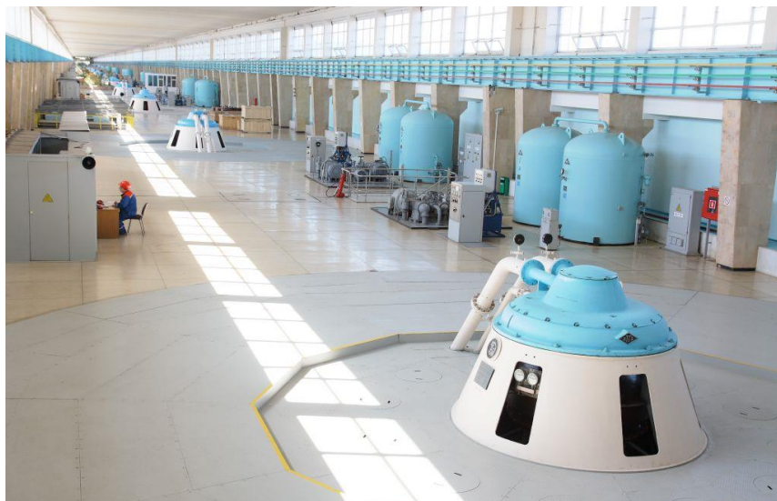
Рисунок 2 – Машинный зал Саратовской ГЭС
