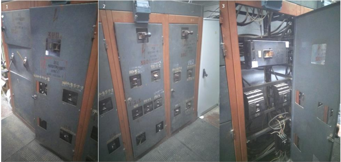
1, 2 – 1, 2, 3 и 4 секции ВРУ; панель наружного освещения и обогрева водостоков; 3 – вторая секция ВРУ внутри/
