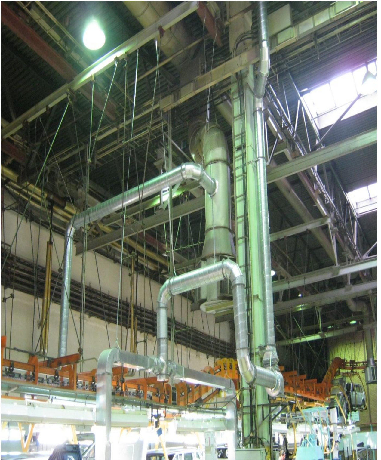
Рисунок 11 – Вид приточной вентиляционной системы
