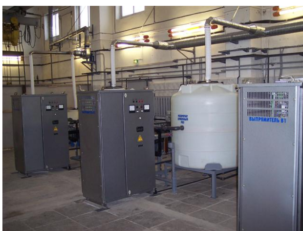
Рисунок 3.6 - Общий вид электролизной установки
