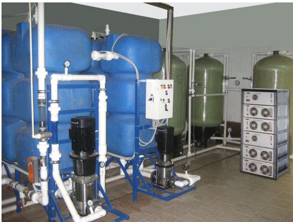
Рисунок 3.7 - Станция озонирования для водоподготовки
