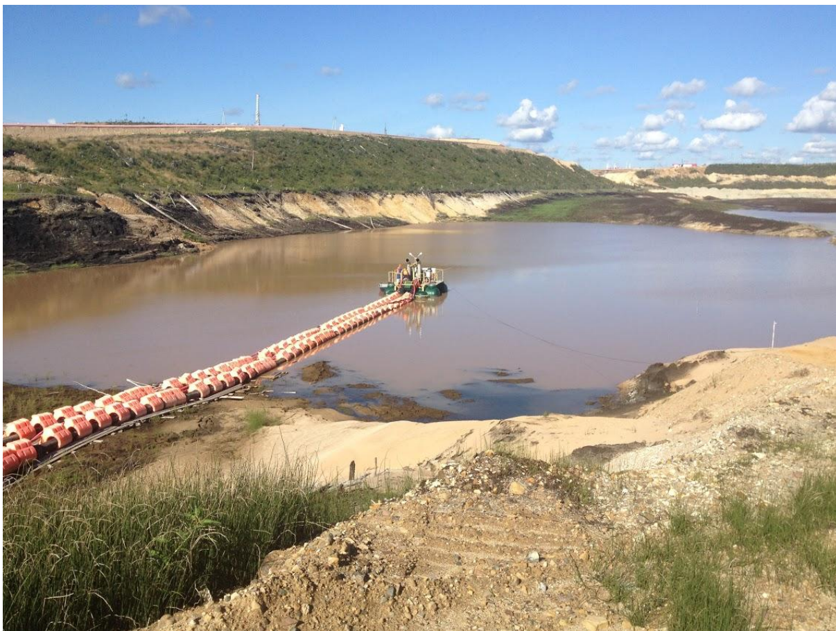
Рисунок 3.16 – Общий вид работающей ПНС
