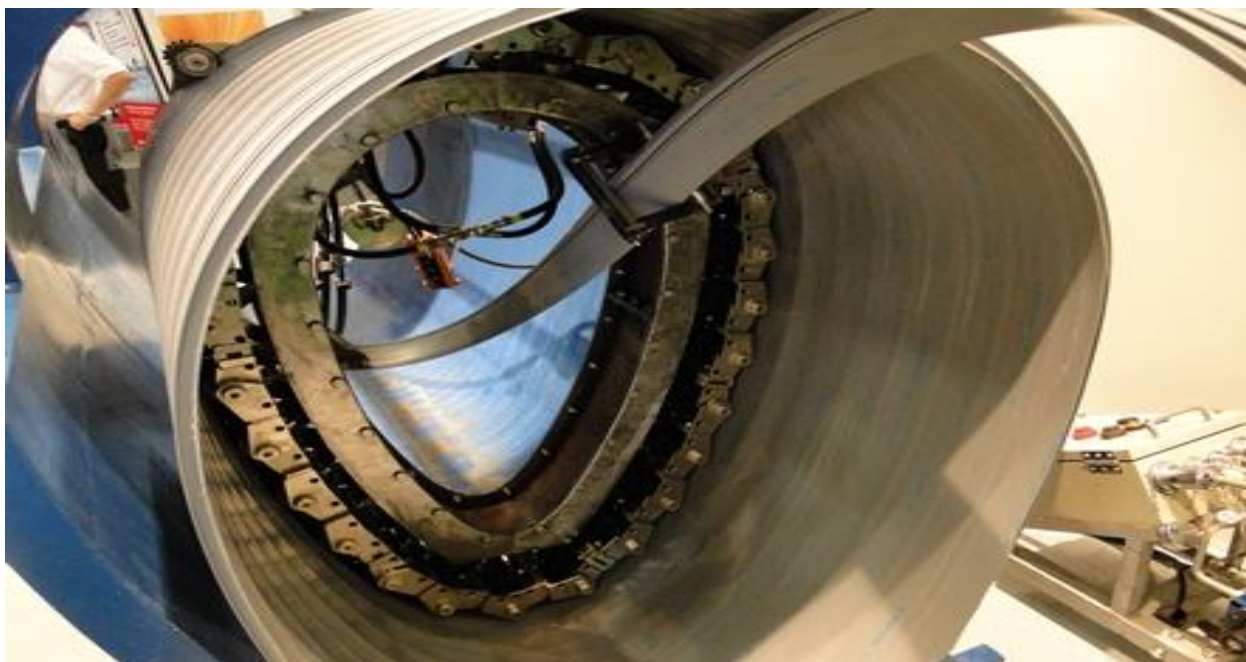
Рисунок №13 Фрагмент подачи ленты и формирования навивочного покрытия внутри трубы яйцеобразного сечения.
