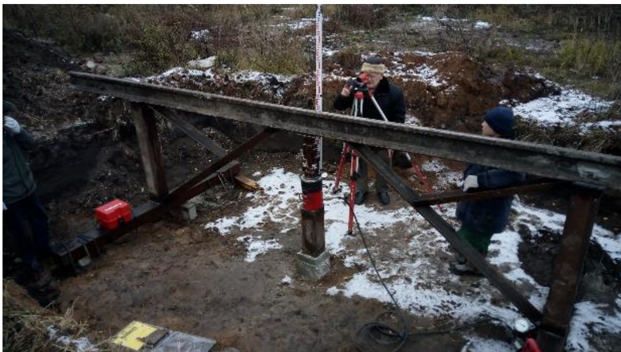
Рисунок В.21 – Испытание буровой сваи статической вдавливающей нагрузкой до усиления упорной фермы
