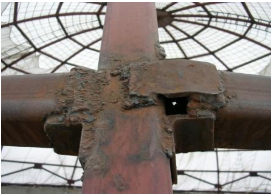
Рисунок 3 - Некачественное выполнение сварных швов
