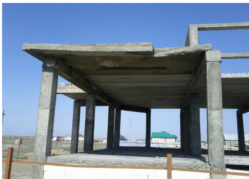
Рисунок 14 – Прогиб плиты покрытия
