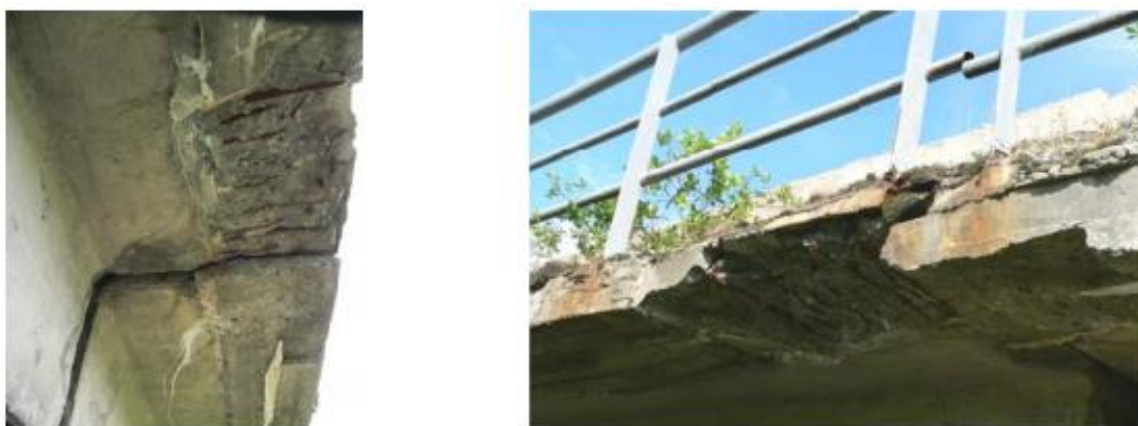
Рисунок 5 – Автодорожный мост с повреждением в виде скола бетона и коррозией оголенной арматуры
