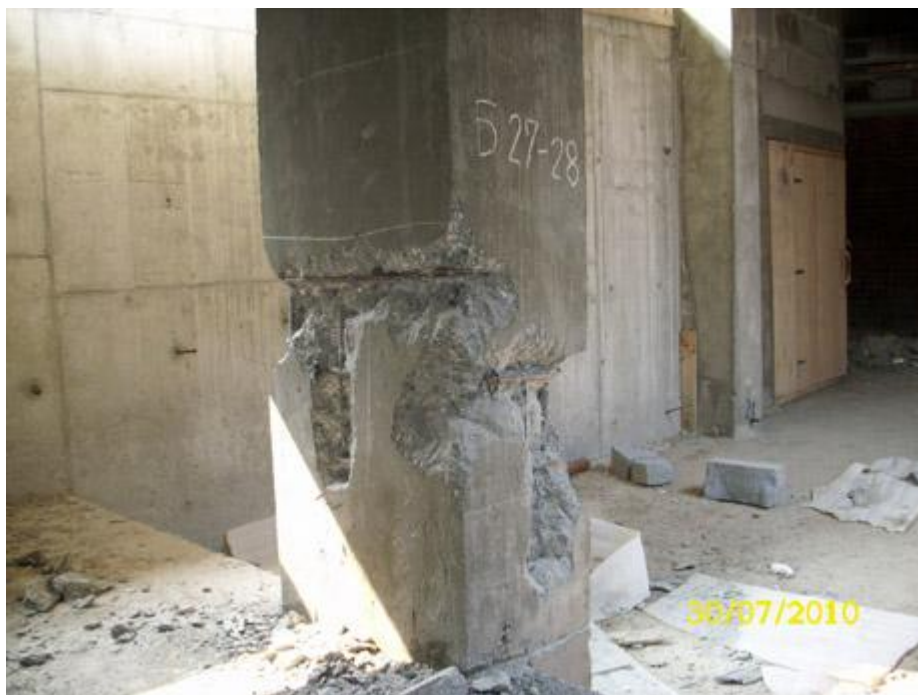
Рисунок 9 – Скол бетона с оголением арматуры
