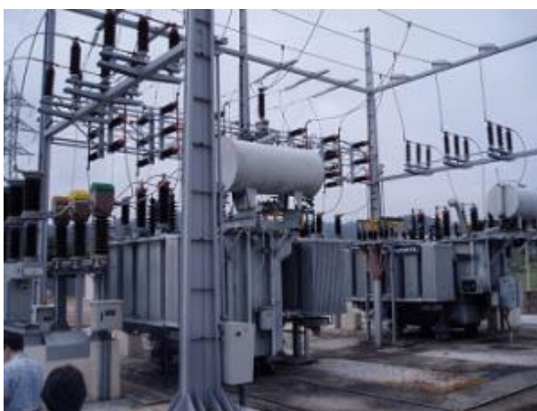
Рисунок 5- Главная понизительная подстанция
