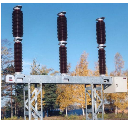
Рисунок 34- Выключатель элегазовый колонковый LTB 145D 1 /B
