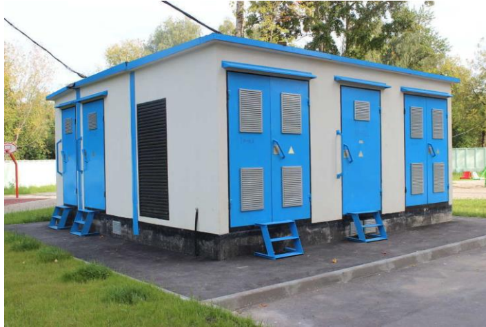
Рисунок 9- Комплектная трансформаторная подстанция
