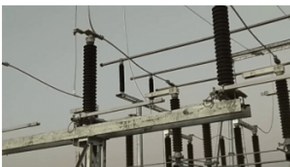
Рисунок 20- Шинопровод на подстанции
