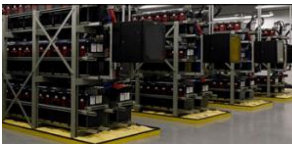
Рисунок 25- Аккумуляторы для подстанций
