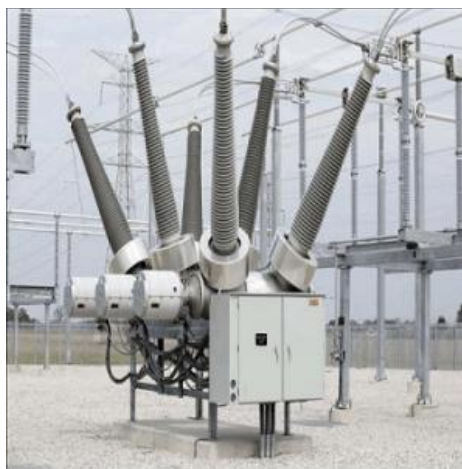
Рисунок 22- Автоматический выключатель элегазового типа
