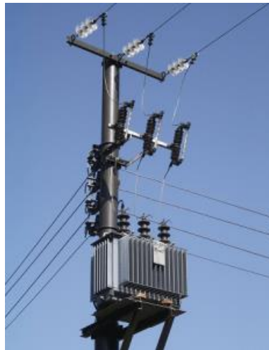
Рисунок 13- Подстанция, установленная на столбе
