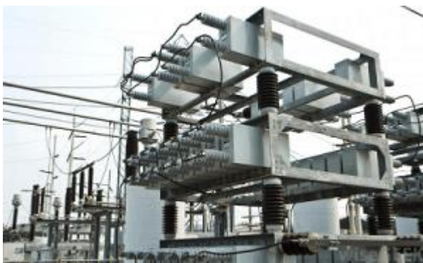
Рисунок 24- Конденсаторные батареи на подстанции
