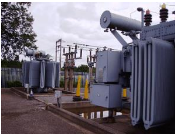
Рисунок 4- Районная (первичная) подстанция
