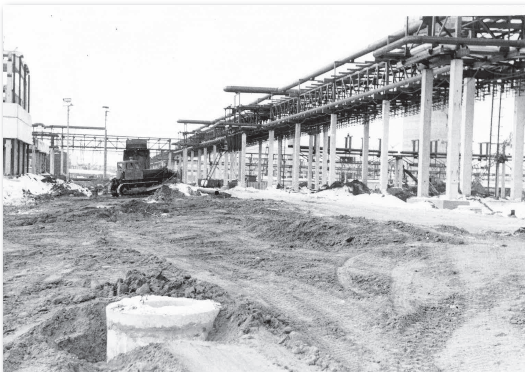
Рис. 4.4. Один из проездов Тольяттинского азотного завода, где выполнены некоторые элементы системы ОПД (1977 г.)
