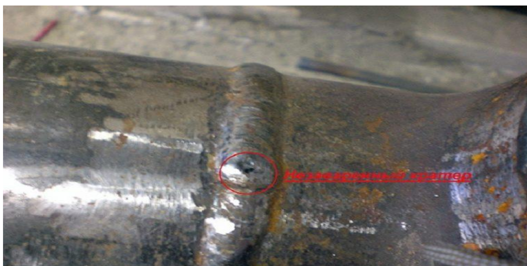
Рисунок 2.10 - Внешний вид кратера трубы D = 200 мм наружного газопровода
