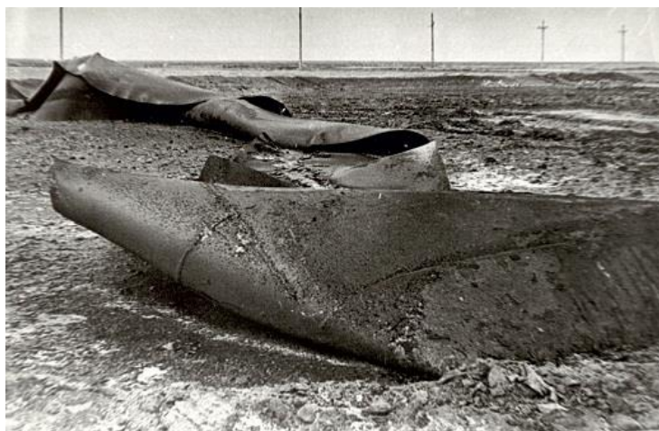
Рисунок 1 – Разрушение газопровода Бухара-Урал
