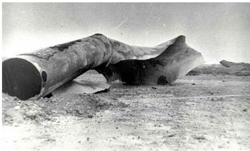
Рисунок 3 – Разрушение газопровода Карадаг-Тбилиси-Ереван
