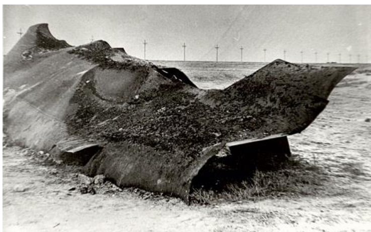
Рисунок 2 – Разрушение газопровода Средняя Азия-Центр
