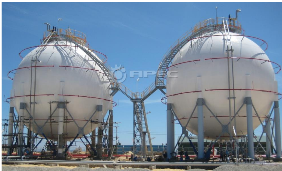
Рисунок 1.1 – Шаровые резервуары для хранения сжиженного газа
