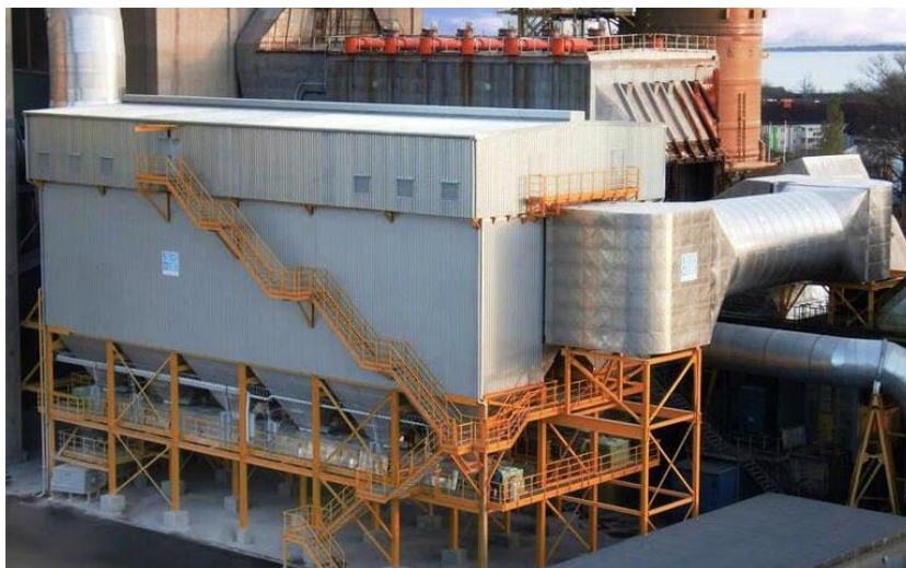
Рисунок 6.1 – Сухой адсорбционный фильтровочный комплекс
