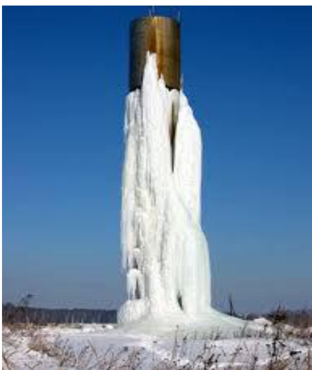
Рисунок 2.10 – Последствия систематического перелива водонапорной башни
