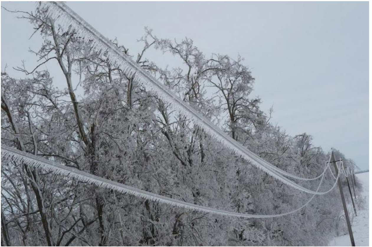
Рисунок 3 – Гололед на проводах ВЛ
