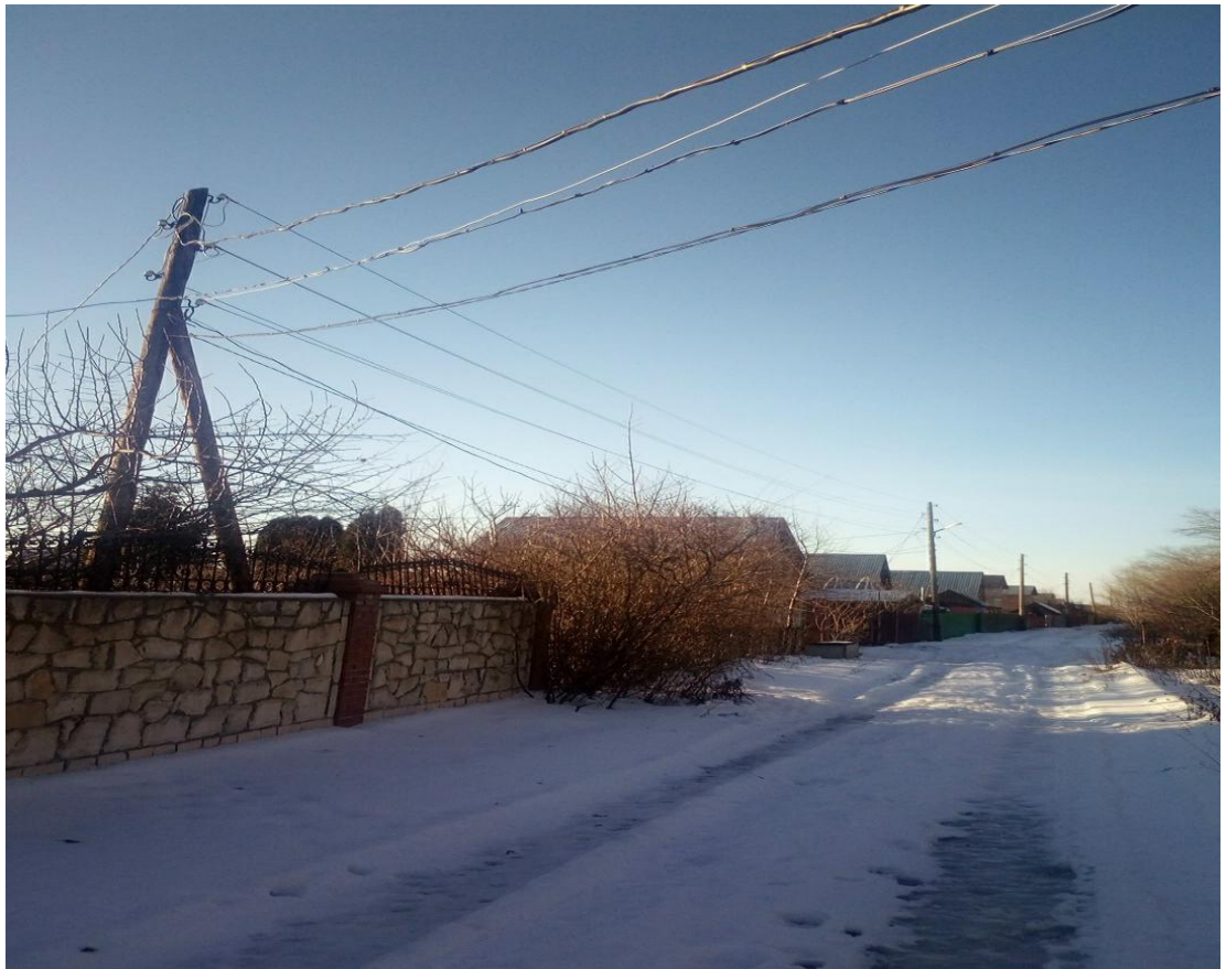
Рисунок 1.3 – Линии электропередач в с. Васильевка
