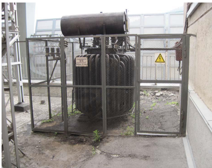
Рисунок 2 – Внешний вид трансформатора 16ТС ЖГЭС
