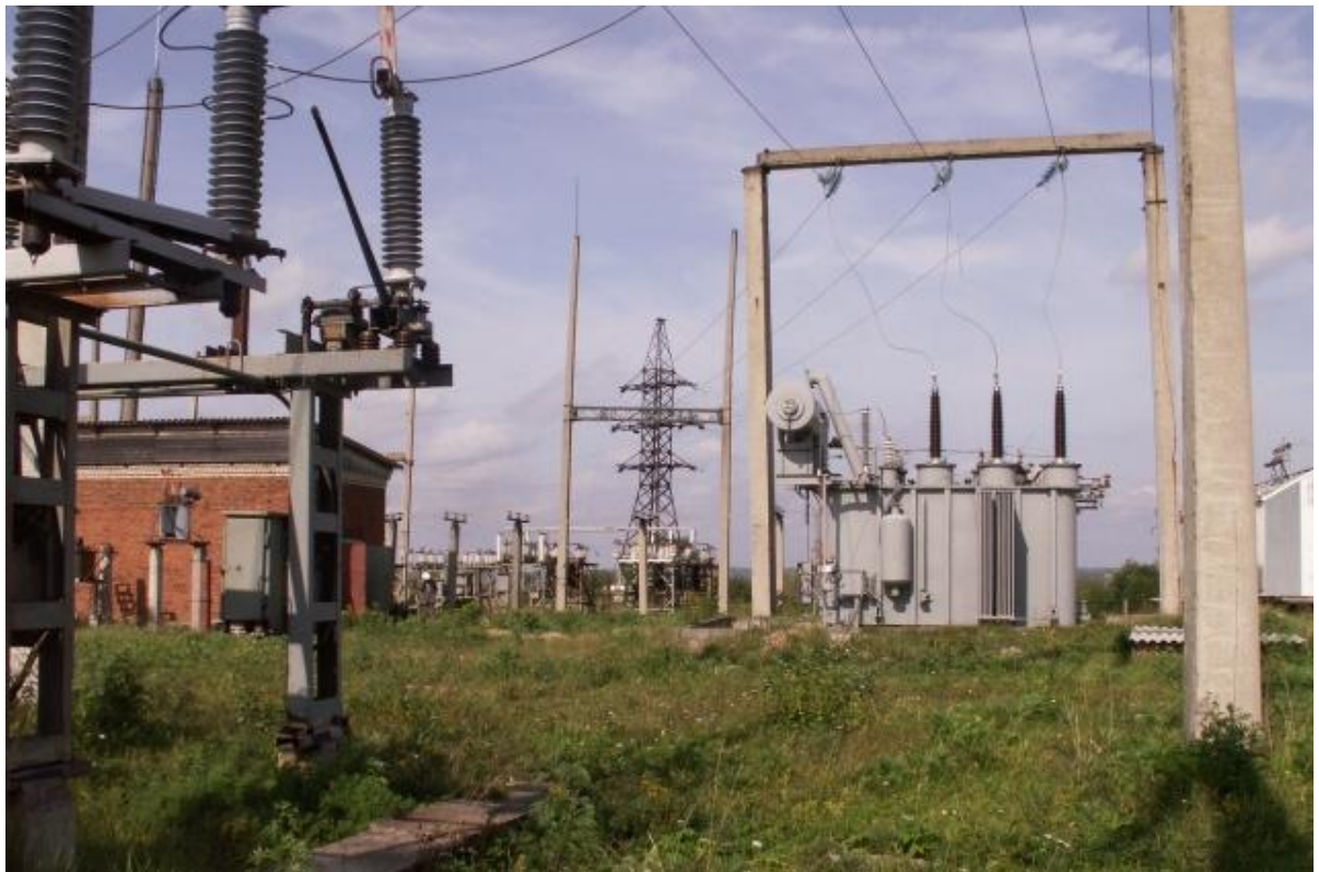
Рисунок 1.1 – ОРУ 110 кВ ПС 110/35/10 кВ «Суворовская»
