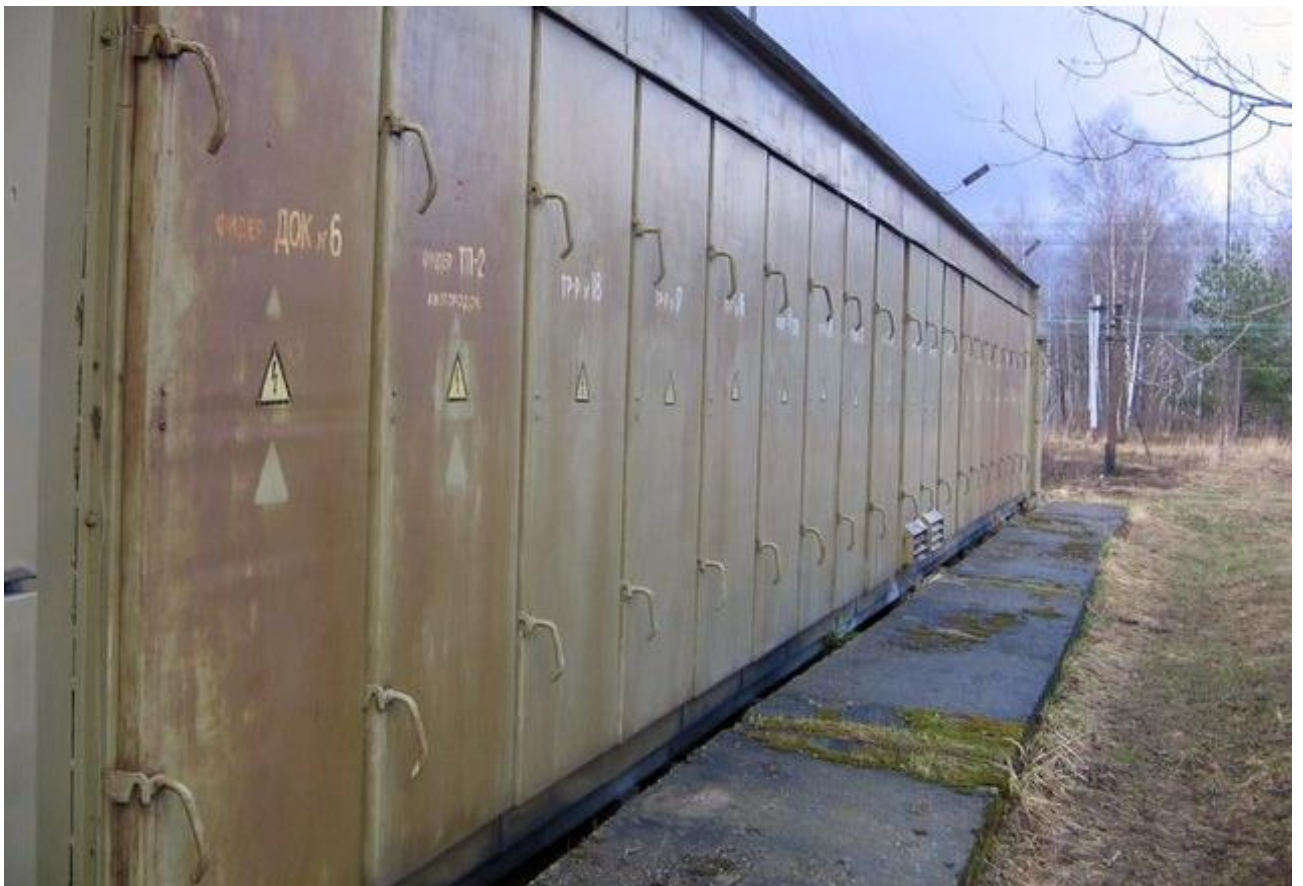
Рисунок 1.2 – КРУ-10 ПС 110/35/10 кВ «Суворовская»
