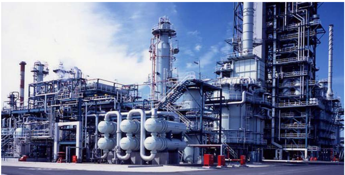
Рисунок 1.1.1 - Установка каталитического риформинга ЛГ-35/11-300
