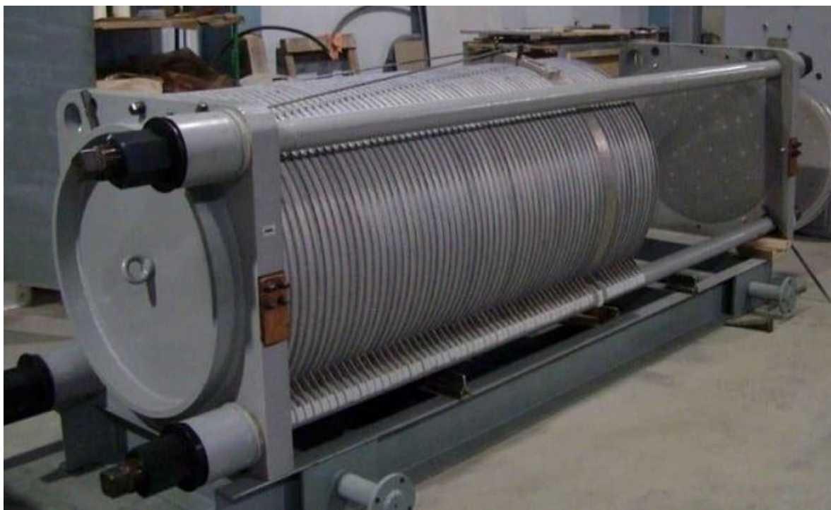
Рис. 2.1 - Промышленная стационарная электролизная установка, вырабатывающая 40\text{ м}^3 водорода в час
