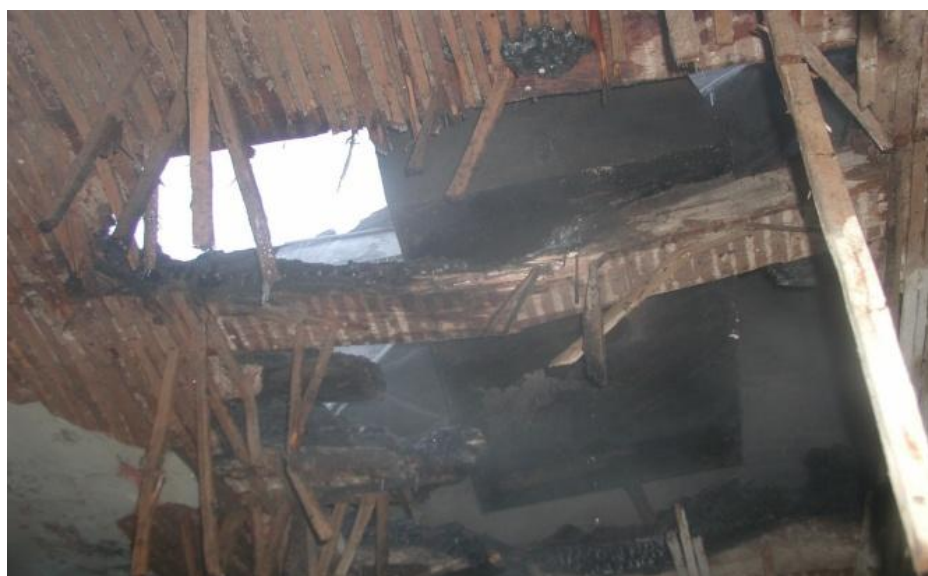
Рисунок 2 -Зона с наибольшими обгоревшими предметами и глубоким разрушением конструкций
