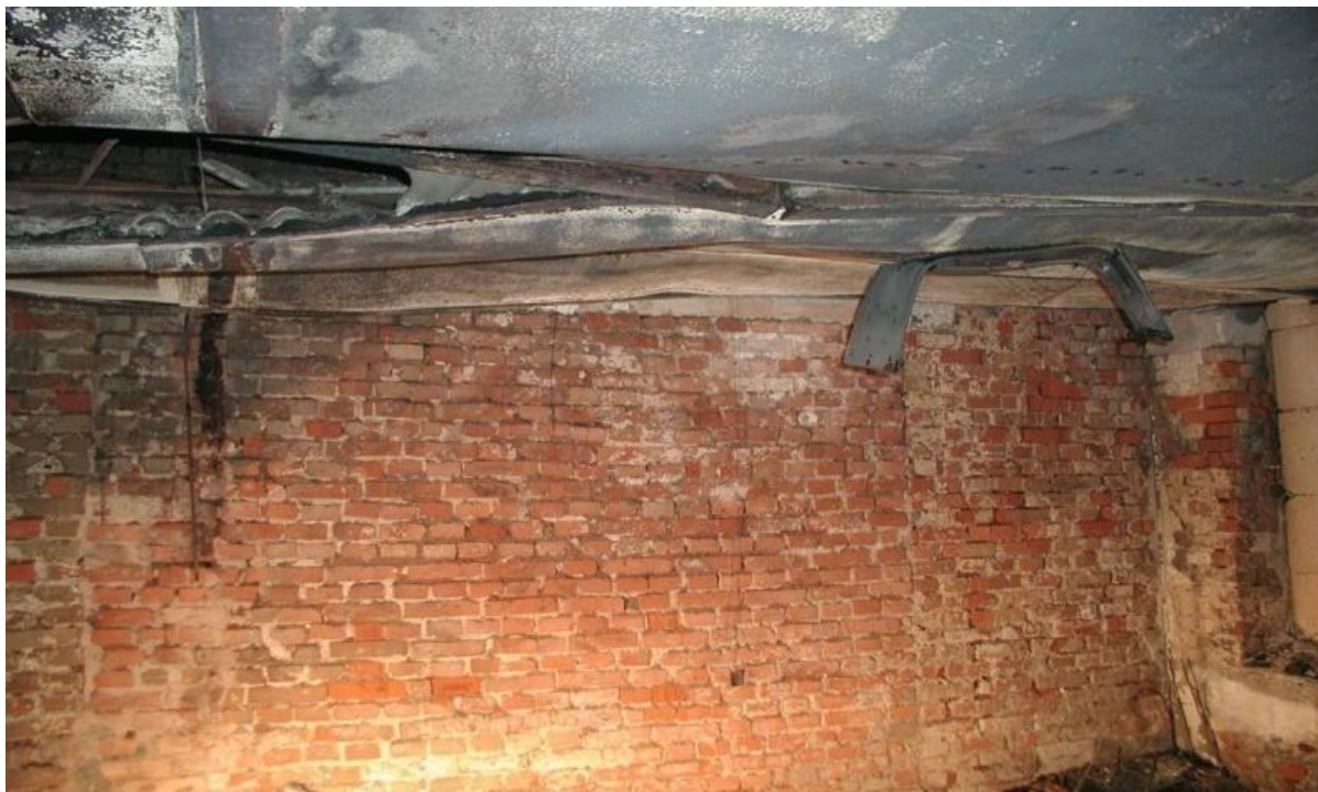
Рисунок 3 - Следы длительного термического воздействия над зоной пожара
