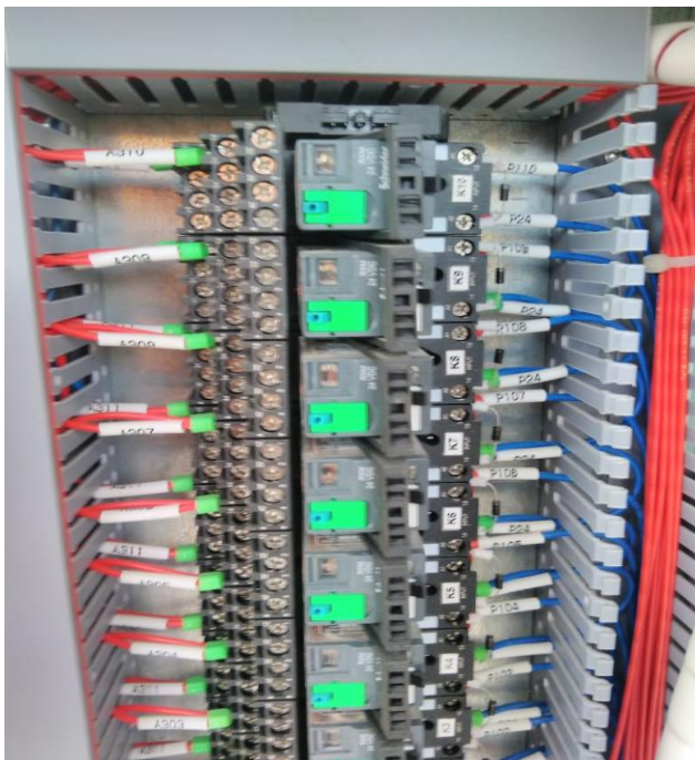
Рисунок 36 – реле силового шкафа
