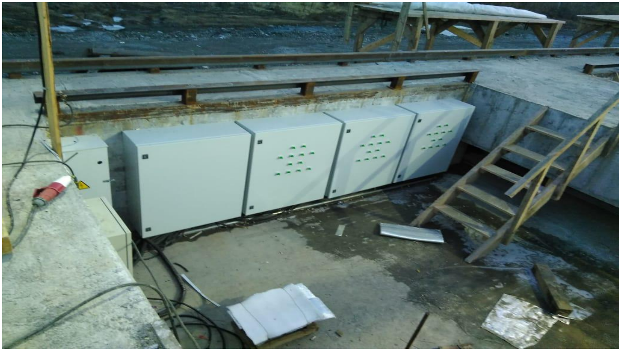
Рисунок 35 – установленные на производстве силовые шкафы и измерительный шкаф
